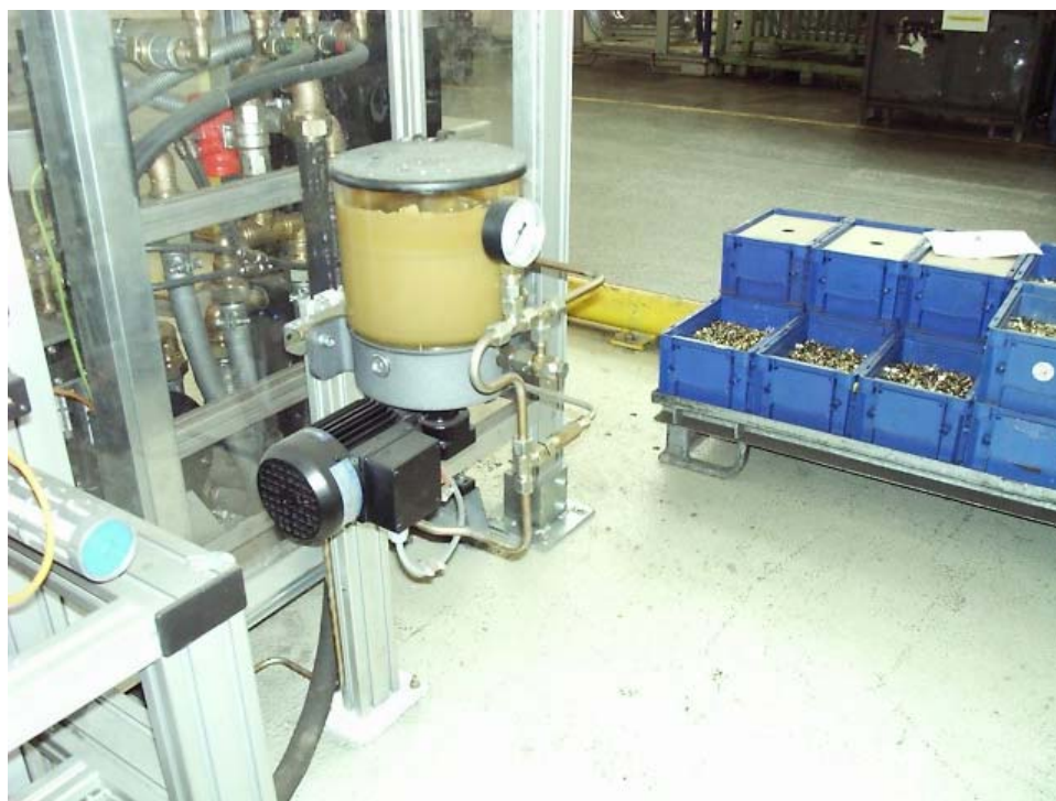
Postazione pompa installata all'esterno del macchinario
